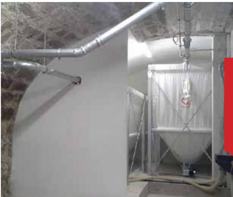
Trogsiloanlage mit Absaugpunkt
